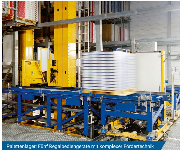
Palettenlager: Fünf Regalbediengeräte mit komplexer Fördertechnik
