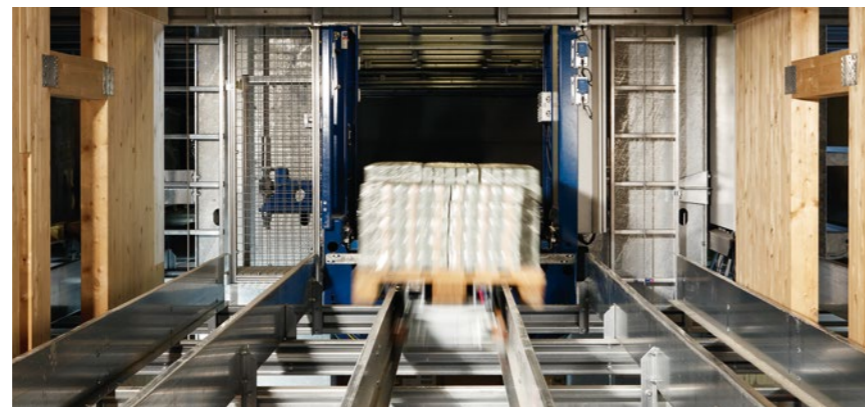
Einlagerung einer Palette mittels Längsshuttle in ein Fach des Holzregals. Für die innovative Konstruktion des Regals zeichnet der Holzbaupionier Kaufmann Bausysteme aus dem benachbarten Bregenzerwald verantwortlich – bewährter LTW-Partner bereits beim ersten Hochregallager aus Holz für die Salinen Austria.
