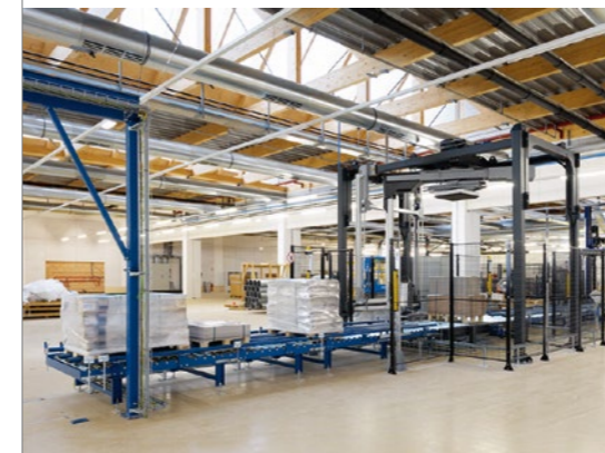
Die Förderstrecke mit automatischer Konturenkontrolle, Umreifung, Wicklung und Etikettierung bewältigt Paletten mit großen Maßunterschieden.
