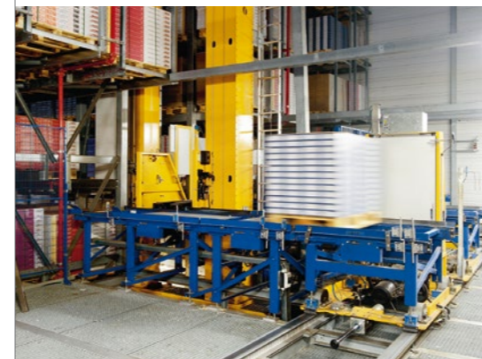
EGGER-Palettenlager mit fünf Regalbediengeräten und komplexer Fördertechnik – bewährte LTW-Qualität in der Projektphase wie im Dauerbetrieb.
