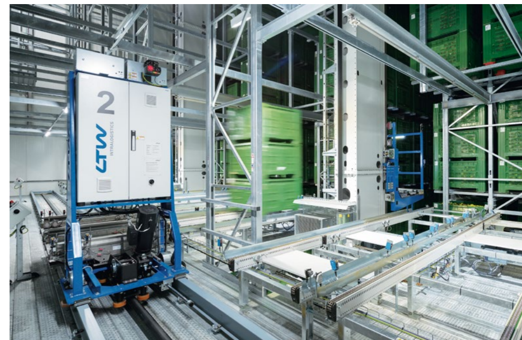
Nicht nur die 28 Meter hohen Regalbediengeräte sind mit der LTW-Riementechnik ausgestattet, sondern auch die beiden Verschiebewagen in der Vorzone (Bild) sowie zwei Vertikalförderer. Der schlupffreie Antrieb und die absolute Längenkonzanz des Riemens ermöglichen hohe kinematische Werte und minimale Beruhigungszeiten.
