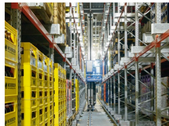
Regalbediengerät mit doppeltiefer Teleskopgabel im Erdgeschoss. Die einmastige Bauweise ermöglicht reduzierte Anfahrmaße und damit ca. 80 zusätzliche Palettenstellplätze.
