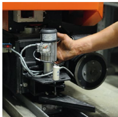
Aktuelle Weichentechnik 2009 mit erneuertem Schaltkeiltrieb und Schaltkeil. Die Weichen sind verschleißarm ausgeführt.
